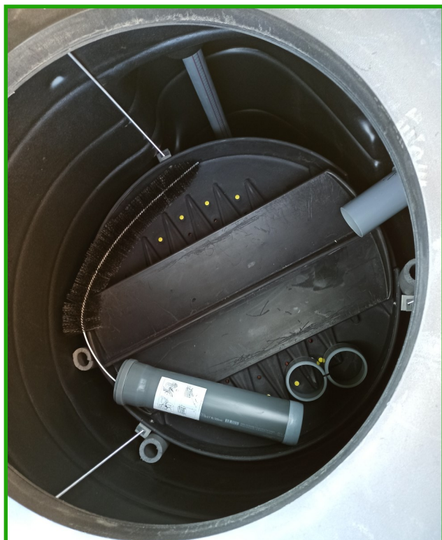
Intérieur de la fosse autonome
